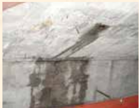
屋根下地からの雨漏り
