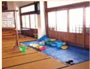
本堂東側の雨漏り
